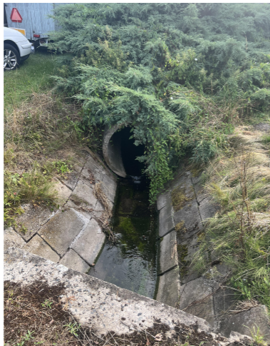
Obrázek 3- Stávající stav Vyústění zatrubněného toku
